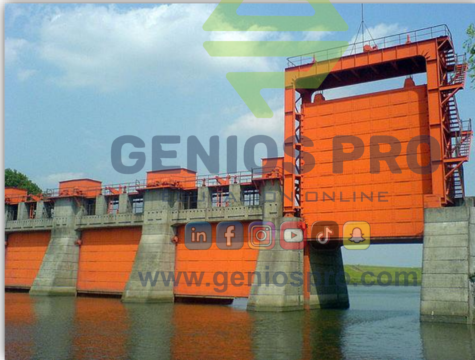
Figura: Compuertas tipo Stoney.
